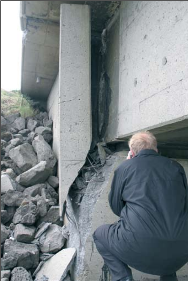
Óseyrarbrú. Hliðarveggur á landsstöpli hefur brotnað þegar burðarbitin slengist til á jarðskjálftalegu.
