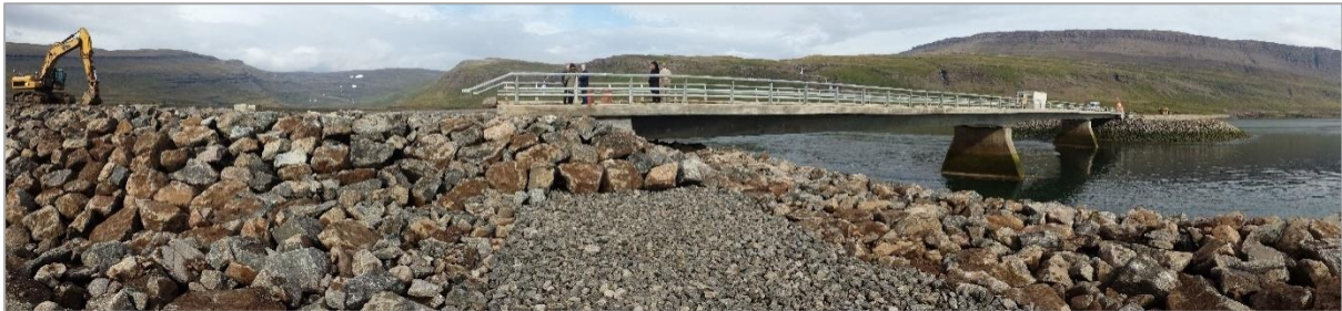
Mynd 4.2.1. Framkvæmdir við 117 m langa brú yfir Kjálkafjörð sumarið 2014 (mynd: Sóley Jónasdóttir).
